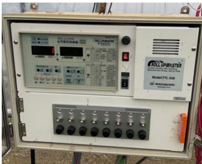
写真12 自動巻き上げ機の制御盤 (モーター8個制御)：約18万円/台
