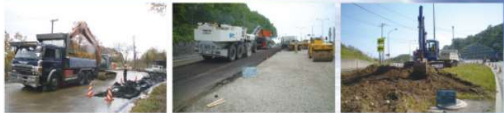
旧道管理道路造成
