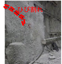
吹付けコンクリートのひび割れ
