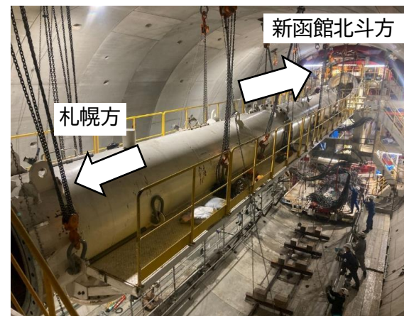
掘削を停止してシールドマシン後方設備組立ての様子
