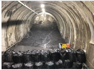
トンネル坑内土砂流入状況
