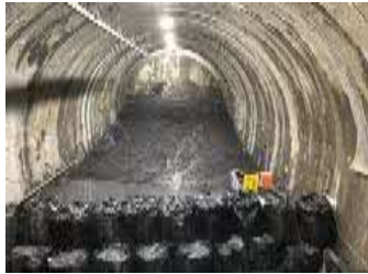
トンネル坑内土砂流入状況
