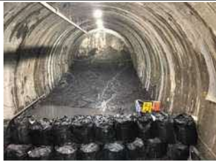
トンネル坑内土砂流入状況
