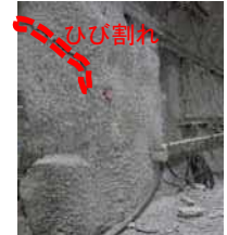
吹付けコンクリートのひび割れ
