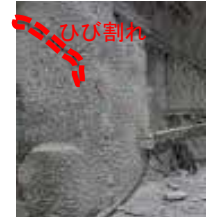
吹付けコンクリートのひび割れ
