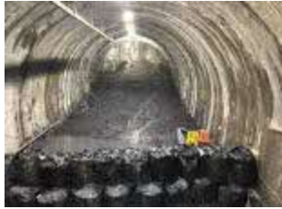
トンネル坑内土砂流入状況
