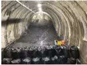
トンネル坑内土砂流入状況
