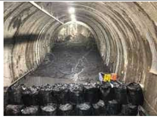
トンネル坑内土砂流入状況
