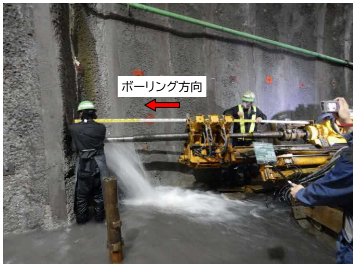
渡島トンネル(南鶉) 先進ボーリングの状況(前方の安山岩層からの大量湧水発生)
