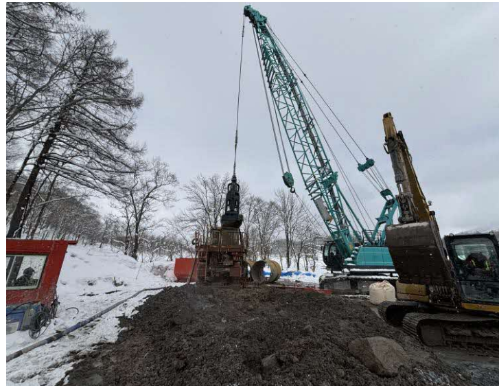
羊蹄トンネル(有島) マシン停止位置付近地上部岩塊撤去状況
