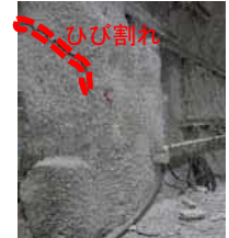
吹付けコンクリートのひび割れ
