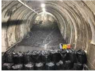
トンネル坑内土砂流入状況
