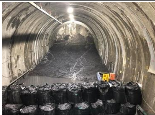
トンネル坑内土砂流入状況
