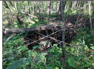
地表面陥没状況
