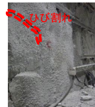
吹付けコンクリートのひび割れ
