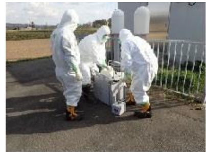
可搬型モニタリングポスト設置
